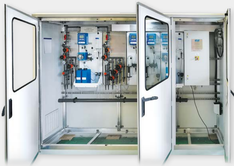
Probenentnahmesystem für Abwasser
